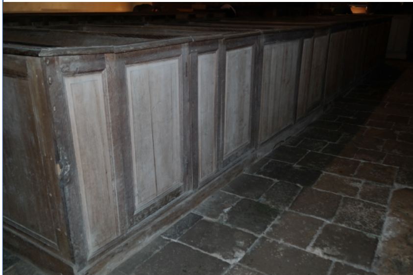
Bancs clos avant les interventions de restauration-conservation.
